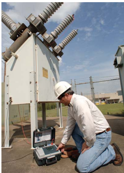
Pomiarowiec używający MIT520 na zakładowej podstacji
