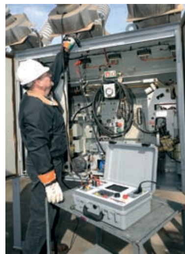
Rys. 5. Miernik Megger MCT1600 podłączony do układu pomiarowego
